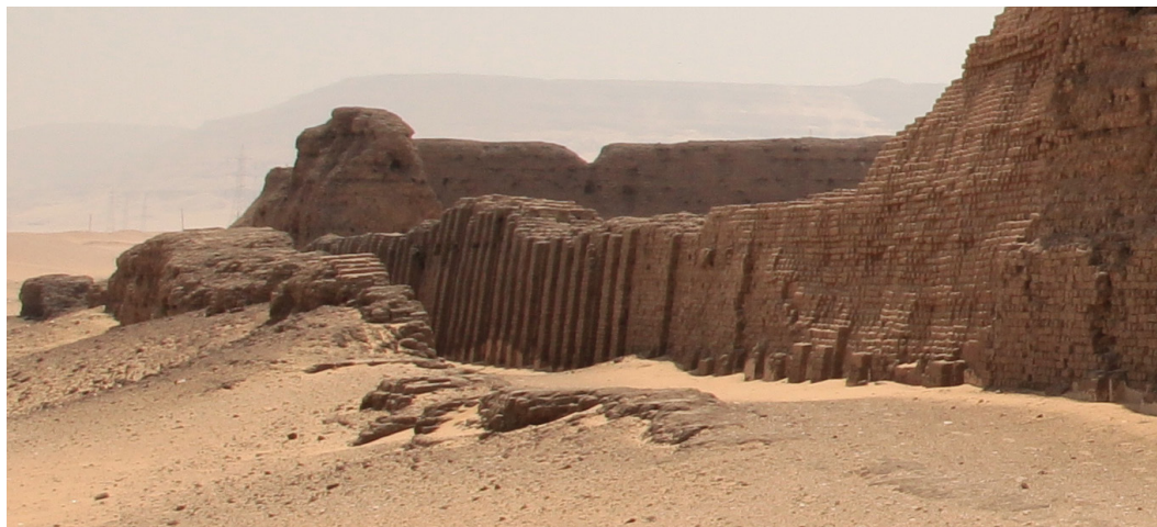
Рис. 1. Фасад стены ограды Шунет эль-Зебиб (II династия, Абидос) с контрфорсами. Фото В. Андросова
